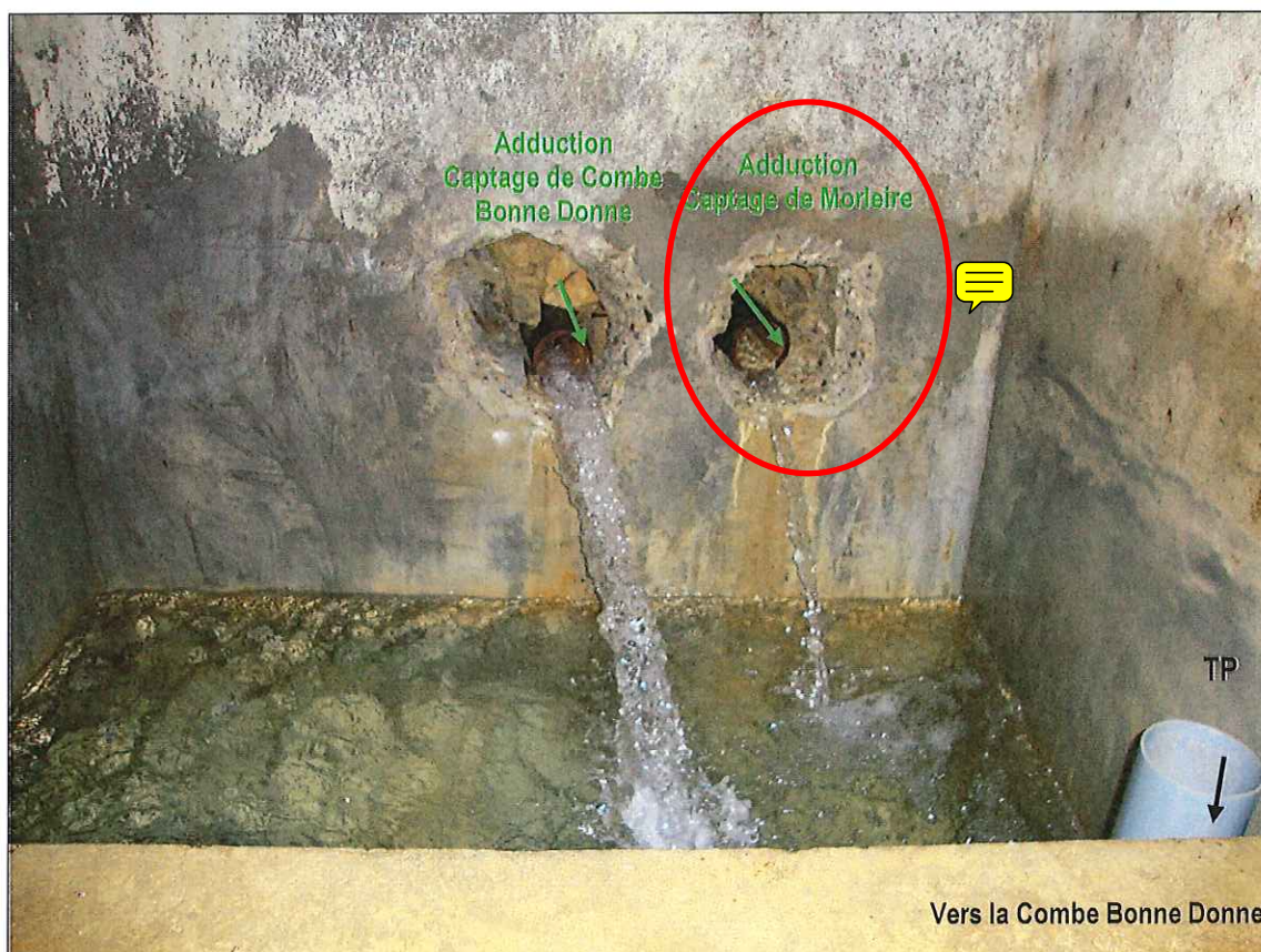
Vue intérieure de la chambre de jonction
