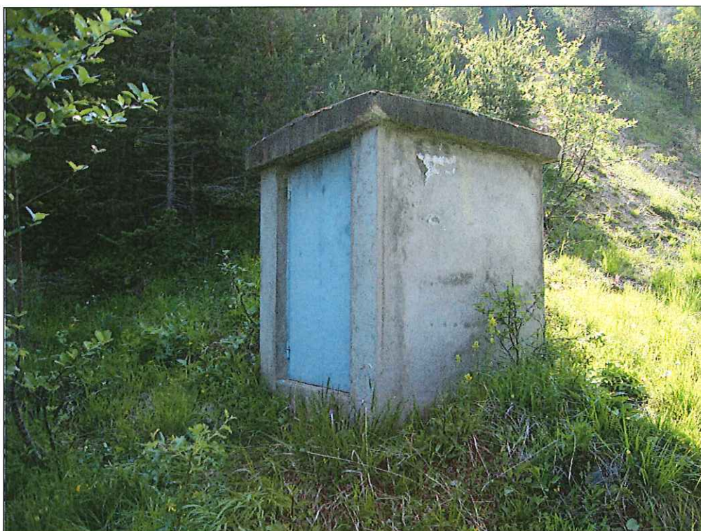
Vue extérieure de la chambre de jonction
