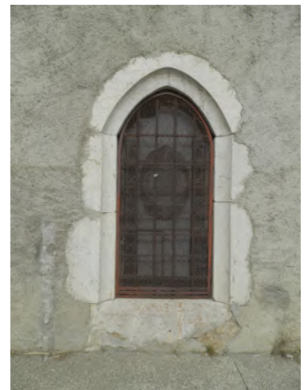
Baie Sud du chœur - Linteau Arc brisé - Nature de pierre identique aux piédroits - Baie d'origine, probablement du 14 e siècle
