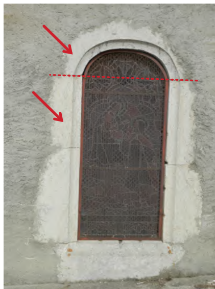
Baie Sud - 3 e travée de la Nef - Linteau arc surbaissé - Nature de pierre différente des piédroits
