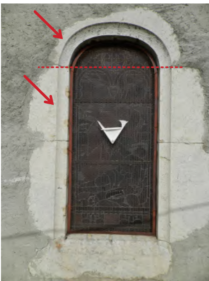
Baie Sud - 2 e travée de la Nef - Linteau arc surbaissé - Nature de pierre différente des piédroits
